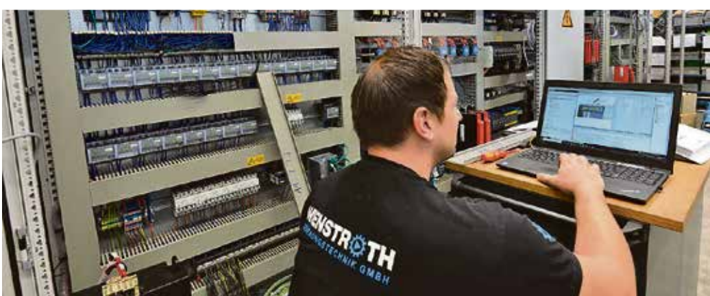
Ein Flammenschleier eines Rollenherdofens (wie oben zu sehen) befindet sich weltweit im Einsatz. Unten: Ein Mitarbeiter bereitet einen Schaltschrank zur Abnahme vor.
